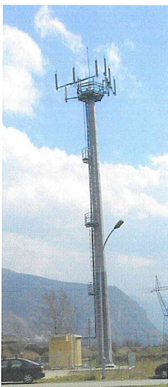
Foto 3. Installazione di tipo raw-land
